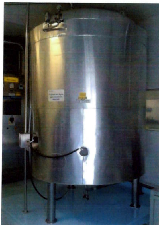
Figura 3 – Tanque de armazenamento
