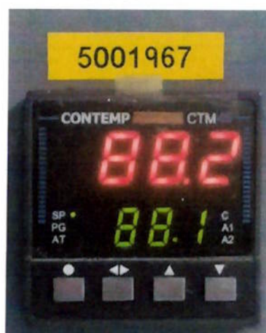
Figura 5 – Controlador de temperatura
